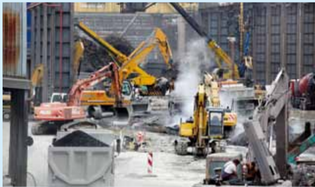
Hoher Aufwand und Einsatz von schwerstem Gerät bei der Umsetzung der Abdichtung des Schlackenbeetes im August 2010: Aufwand der belohnt wurde – mit sinkenden Werten bei der Grundwasserbelastung und der Anerkennung der Maßnahme bei Gericht
