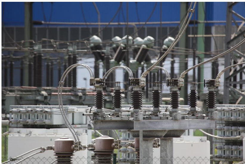
Bild 02: Umspannwerk der Lech-Stahlwerke GmbH.
